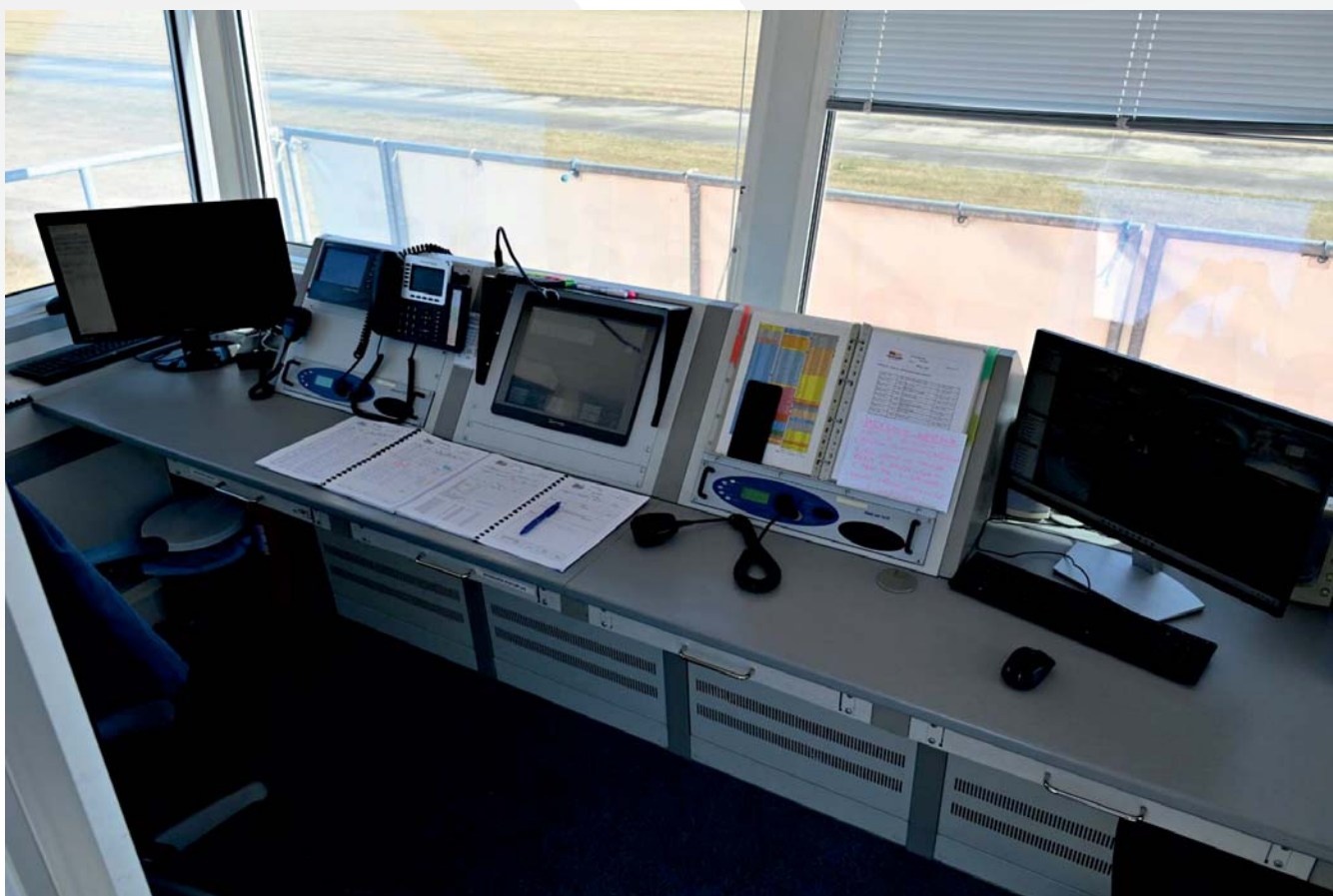
Pohled na modernizované technické vybavení stanoviště PIP
